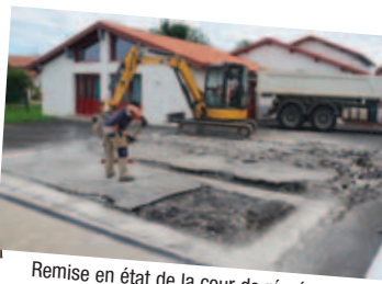
Remise en état de la cour de récréation suite à l'enlèvement de l'algéco
